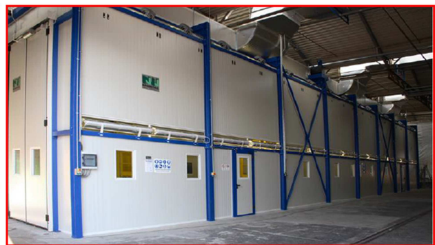
Figura 12 Impianto di verniciatura in box
