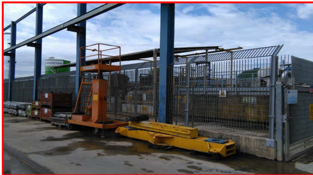
Figura 21 Impianto di depurazione
